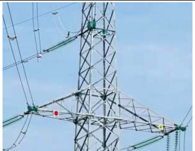
#29 杆塔警告标识 2
