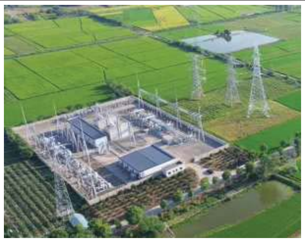
同心 220kV 变电站现状
